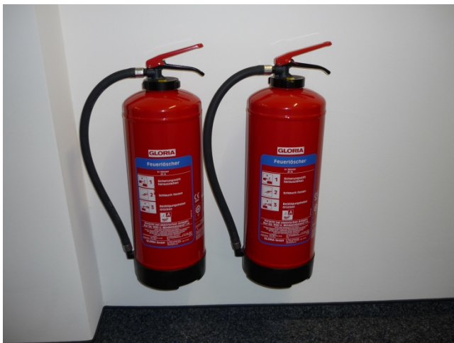
Beispiel für die gut sichtbare Anbringung von Feuerlöschern
